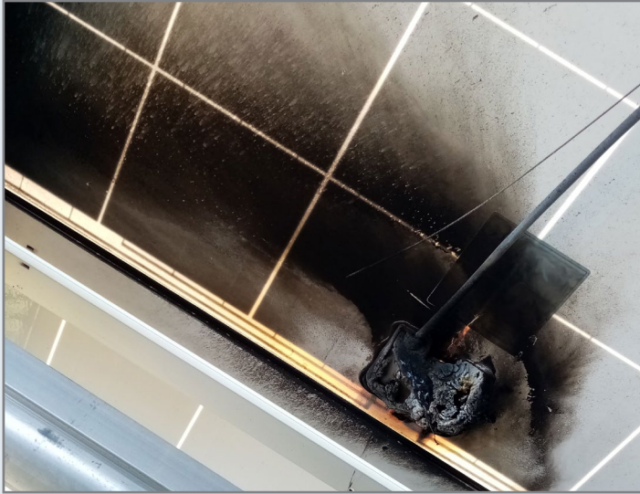
上图显示了电站光伏组件的接线盒因电弧而熔化。
